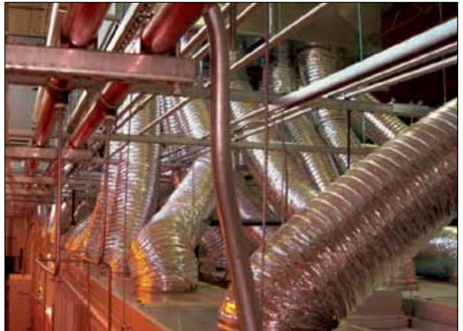
洁净室中的暖通空调系统
